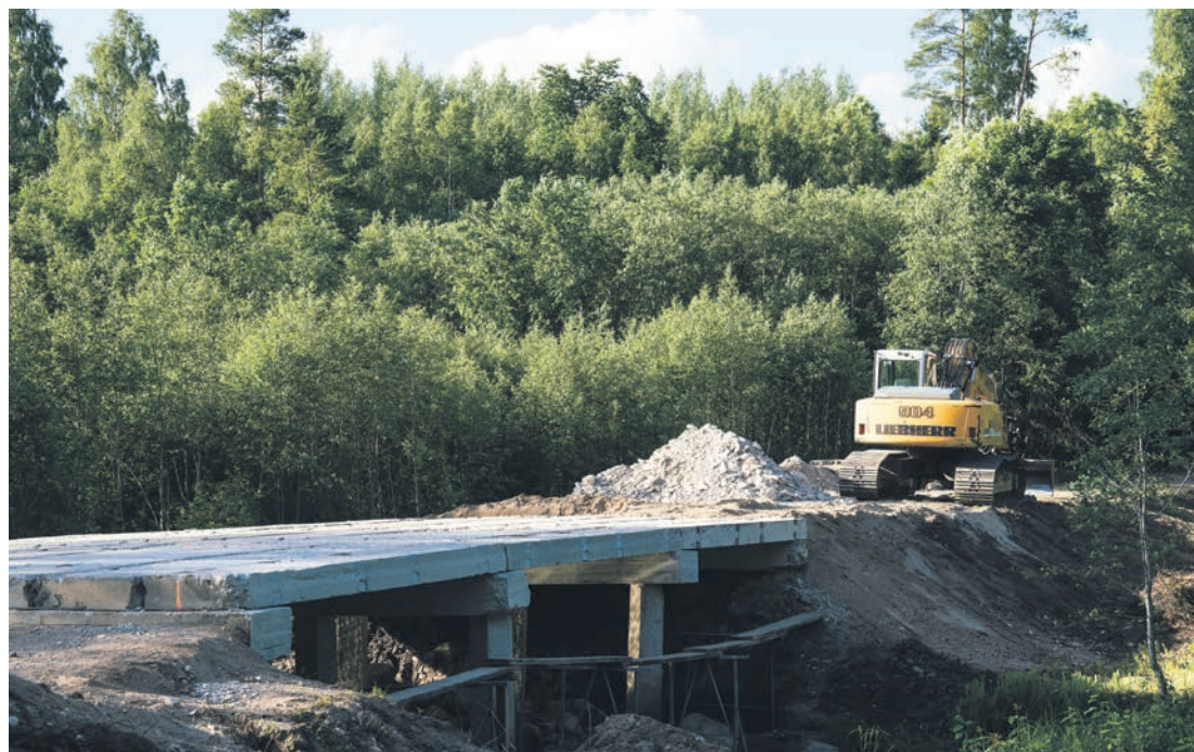
ATJAUNO TILTU. Maija beigās Seces pagastā uzsākti tilta pār Lauces upi uz autoceļa Šķitiņi–Stalāni pārbūves darbi, līdz ar to no 27. maija tilts ir slēgts satiksmei.
